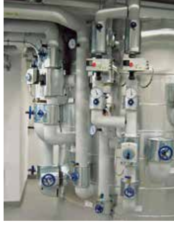
Beispielgebend für andere Kommunen: Die energetische Optimierung der Kläranlage Roth (hier ein Blick in die Heizzentrale). Foto: Stadt Roth
